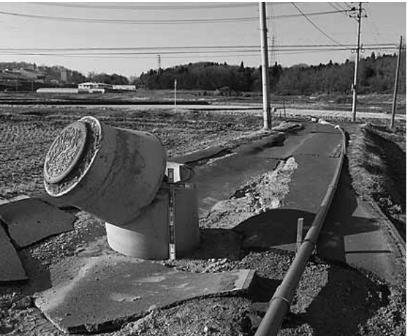
下水道農集被災状況
